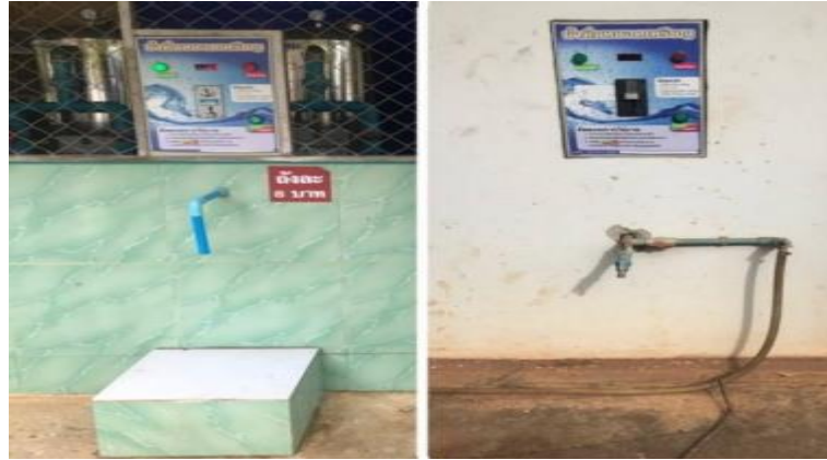
รูปที่ 3 ตู้น้ำดื่มหยอดเหรียญอัตโนมัติแบบมีหัวบรรจุติดตั้งอยู่ที่ผนังภายนอกอาคาร แบบไม่มีช่องจ่ายน้ำ (ที่มา: นำนันทิพย์ มุมมาลา, ดนิตา ภาณุจรส, สีนินาฏ กริชชาญชัย และณัฐธิญา คำผล, 2563)
